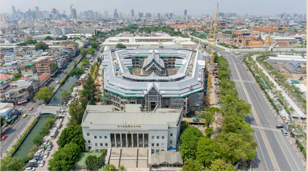
ภาพ : การก่อสร้างอาคารศาลฎีกาแบบใหม่ ไทยประยุกต์ เอื้อเฟื้อโดย : พงศ์ธร ธาราชชัย, PPS Group Photo: Construction of the new Supreme Court building in a contemporary Thai style. Item courtesy of: Phongthon Tharachai, PPS Group.
